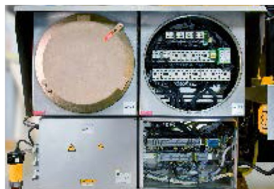
Электрощафы и управление
